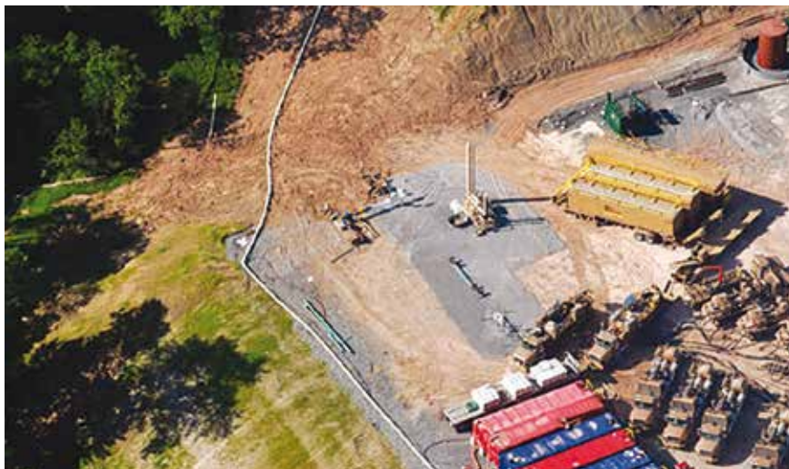
L'une des nombreuses exploitations sur le champ de Marcellus (Virginie occidentale-Pennsylvanie). Après un forage vertical, les compresseurs transportés sur les camions provoquent une pression qui fracture la roche. Le gaz liquide est évacué par un tube provisoire et stocké dans les réservoirs rouges et bleus.
